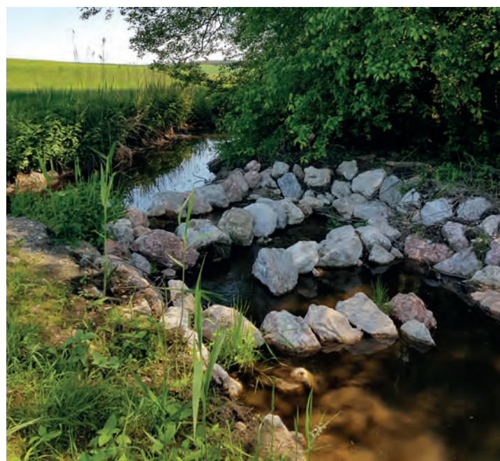
Fischaufstiegshilfe im Röthenbach
